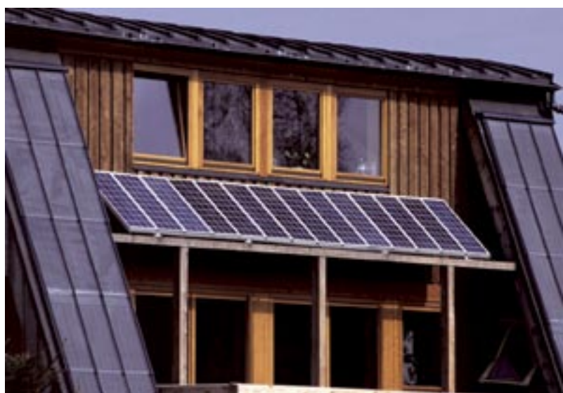
Рис. 7. Солнечные батареи на крышах домов
